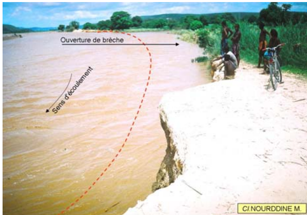
Figure 3. Le Fihierenana en crue : rupture de la digue et de la route reliant le pont de Belalanda avec Miary (12/06 et 01/07). Quid du coût de reconstruction ?
